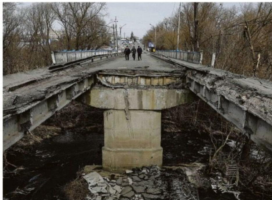
DISTRUZIONE Il ponte di Malyn, nell'Ucraina occidentale, crollato sotto il fuoco dei bombardamenti russi
